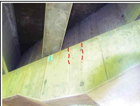
cw=0.3\text{mm} 이상 균열(P1)
