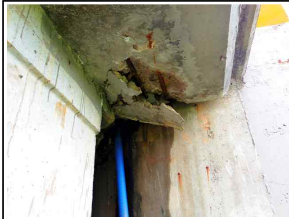
철근노출 및 파손(S8)
